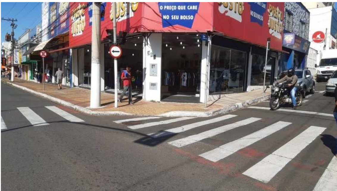
Figura 50 - Rampa de acessibilidade fora do padrão Avenida Dr. Antônio Lobo, 399, Centro
