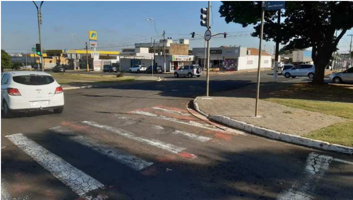
Figura 51 - Rampa de acessibilidade fora do padrão Avenida Antônio Pinto Duarte, 1392, Campo Limpo
