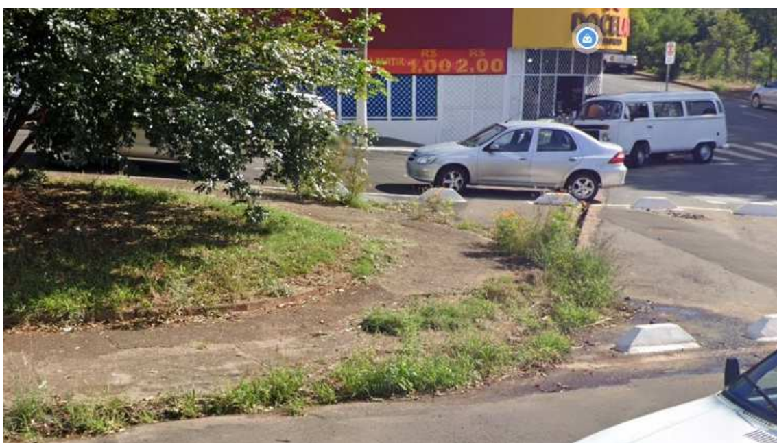
Figura 45 - Calçada danificada e com mato alto Avenida Abdo Najar, nº 1179, Vila Gallo
