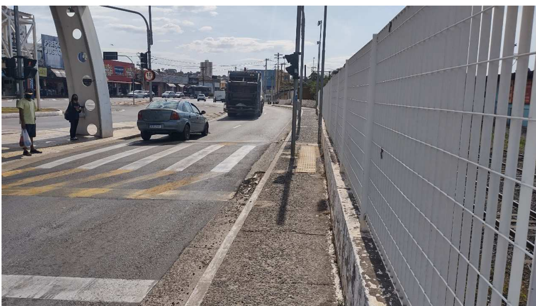
Imagem x: Calçada com largura útil inapropriada Avenida Dr. Antônio Lobo, S/N, Centro – Terminal Metropolitano de Americana
