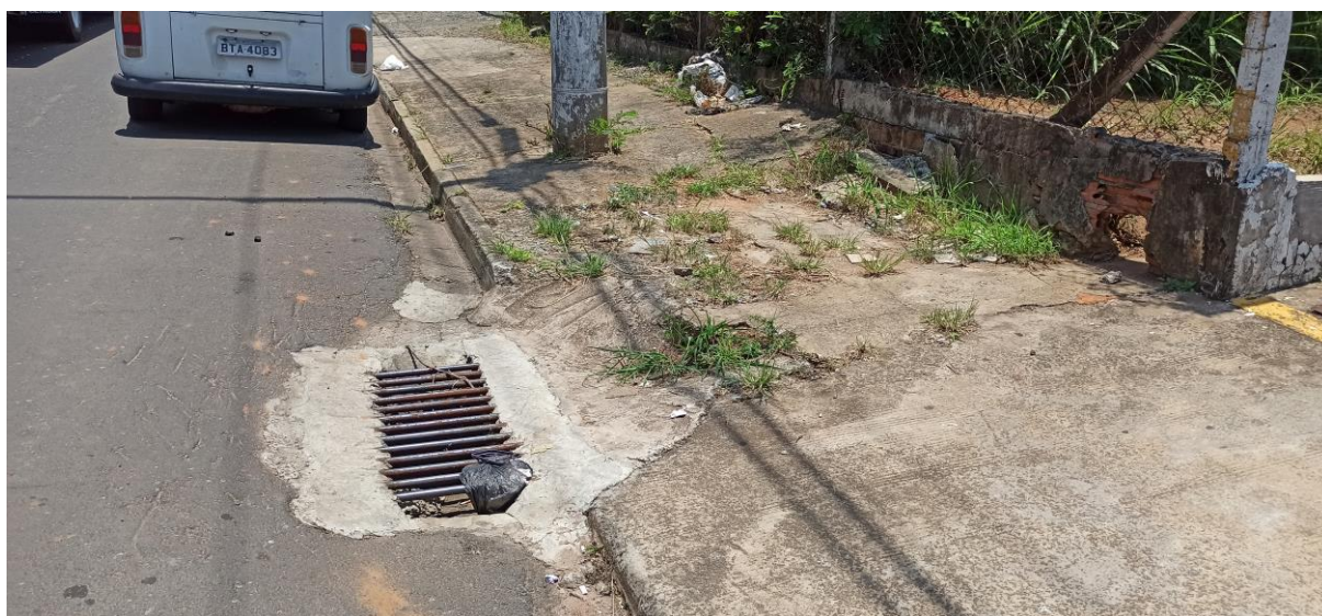
Figura 38. Vista de uma caixa coletora de águas pluviais com grade.
