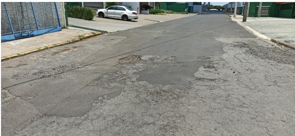
Figura 52. Condição da pavimentação com buracos e desagregação.
