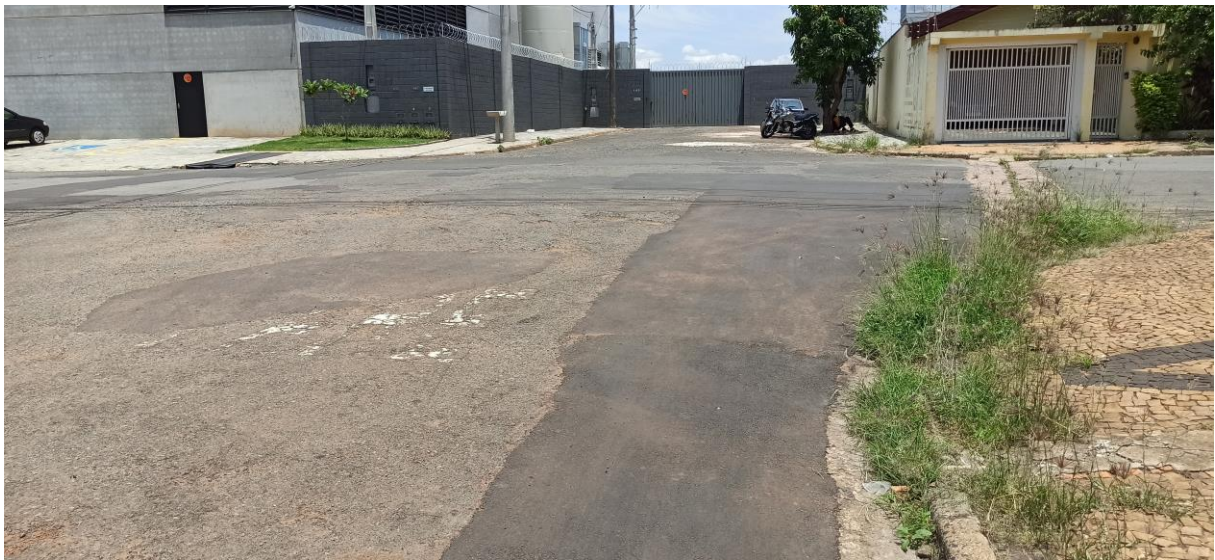
Figura 51. Condição da pavimentação com muitos remendos.
