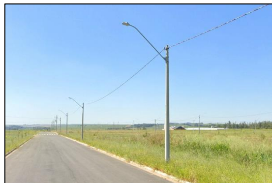
Postes de iluminação e rede elétrica
