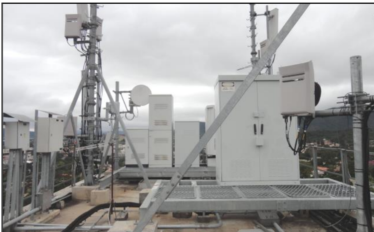
Foto 04 – Vista parcial dos equipamentos que compõem a ERB, instalados no topo do edifício.
