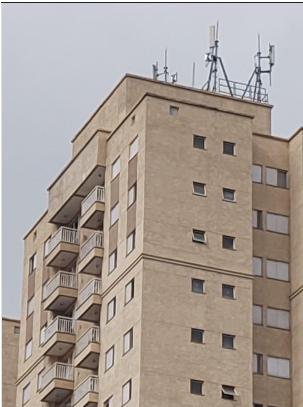
Foto 12 – Detalhe da ERB instalada no topo.
