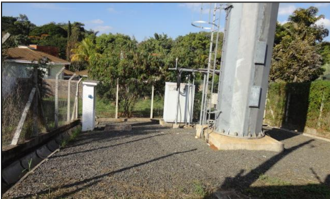
Foto 02 – Vista parcial do interior da ERB, com estrutura vertical e equipamentos no solo.
