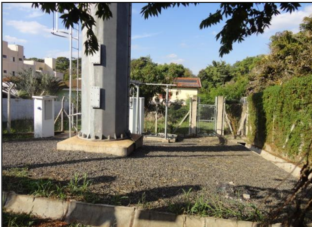
Foto 08 – Vista do interior do site, com poste tubular metálico, esteiramento para cabos e gabinete metálico padrão ATC para abrigar o conjunto de equipamentos.
