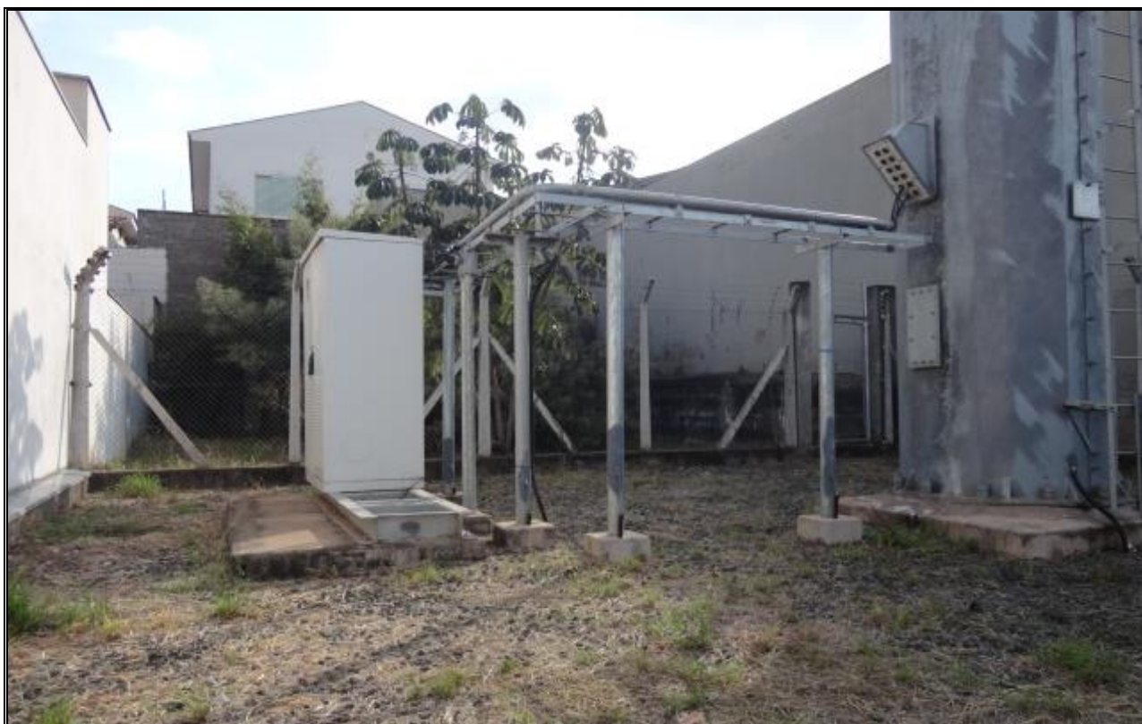
Foto 03 – Vista parcial dos equipamentos que compõem a estação radio base.
