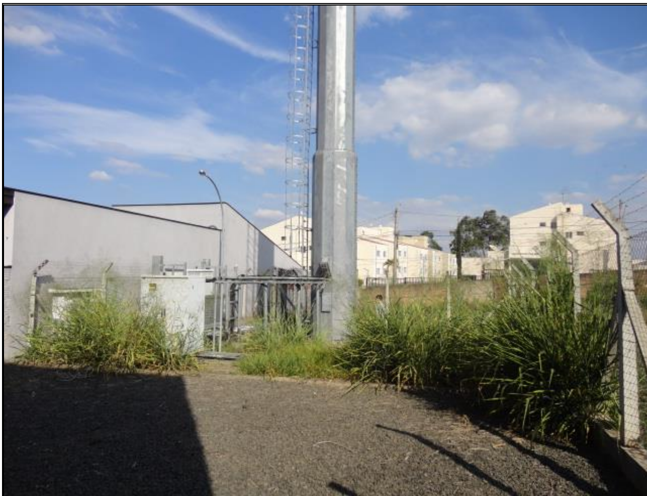
Foto 08 – Vista do interior do site, com poste tubular metálico, esteiramento para cabos e gabinete metálico padrão ATC para abrigar o conjunto de equipamentos.
