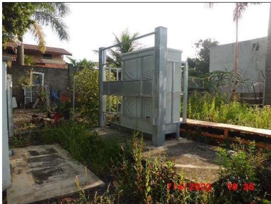
Foto 6.6-13: Área interna: BTS.
