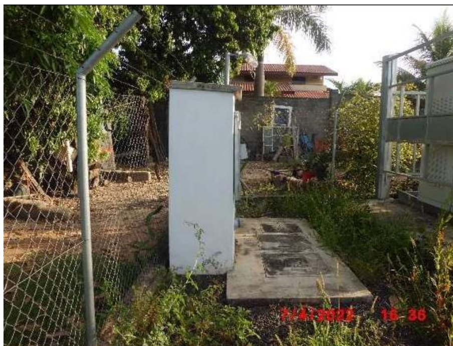
Foto 6.6-14: Área interna: QD energia – Caixas de passagem.
