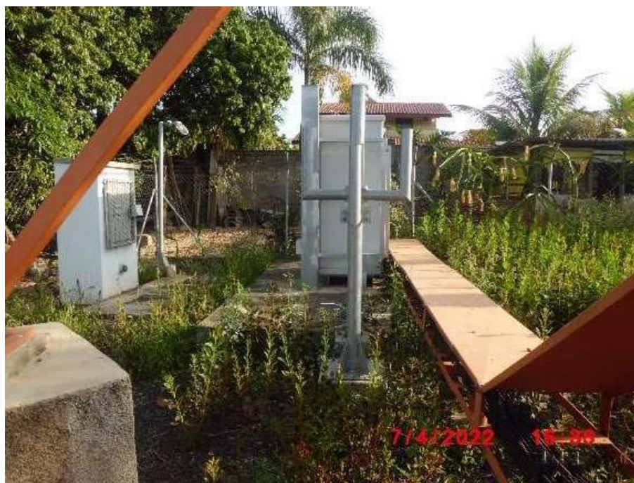
Foto 6.6-10: Área interna: instalações.
