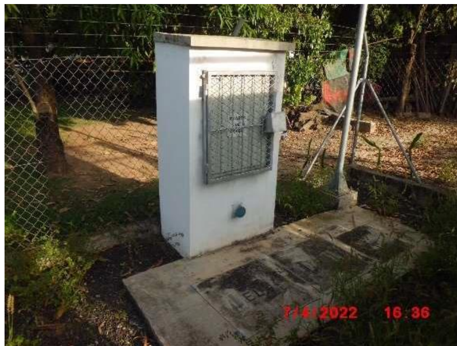
Foto 6.6-15: Área interna: QD energia.
